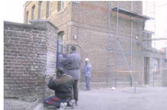
Le PLIE a permis la mise en œuvre du chantier d'insertion conduit par la commune de Oisy pour rénover un bâtiment communal.
