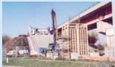
► chantier AZ1 : doublement du pont au-dessus de la voie ferrée à hauteur d'Escaudain.
